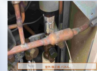
窓外機正面 パネリ
