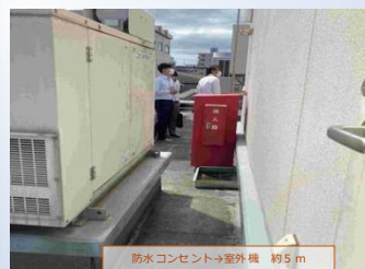
防水コンセント→室外機 約5 m
