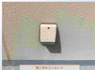
屋上防水コンセント
